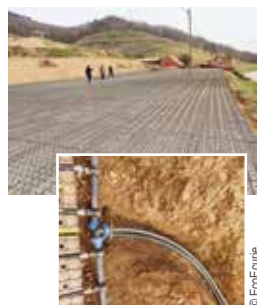
Installation de la subirrigation de la carrière de la Ferme du poney roi
